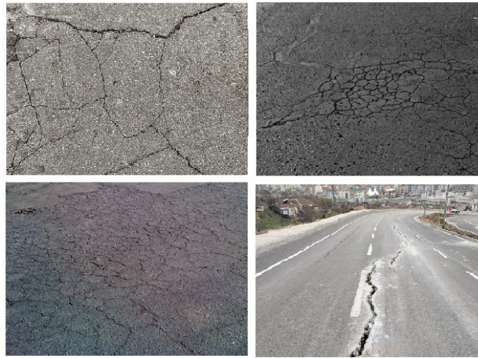
Şekil 1.1. Gerçek otoyol çatlak görüntüleri
