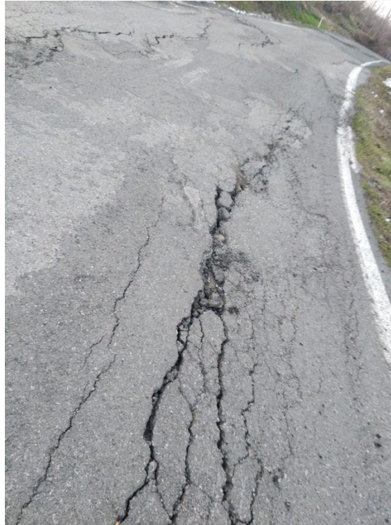
Şekil 6.16. Yol çatlak görüntüsü
