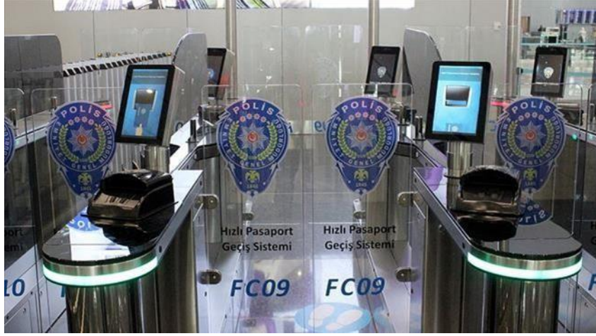
Görsel 2.9. Hızlı Pasaport Geçiş Sistemi - İstanbul Havalimanı (http-15)
