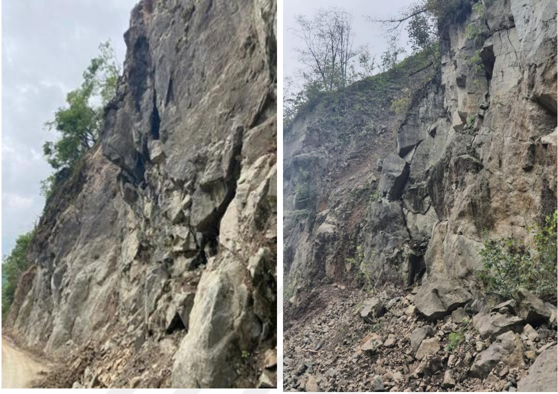
Şekil 4. KM: 09+800 – 09+900 güzergâhında bulunan düşme riski yüksek olan bloklar
