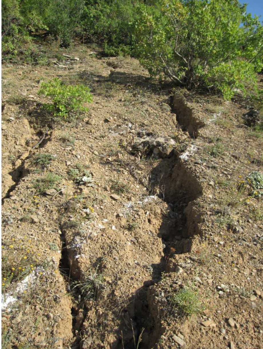
Şekil 4.5 : Taç bölgesi arkasında gelişen çekme çatlakları.
