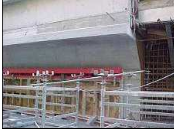
Resim 2.5 Almanya'dan KYB uygulaması, sel bariyer duvarı (Gürdal ve Yüceer 2004)
