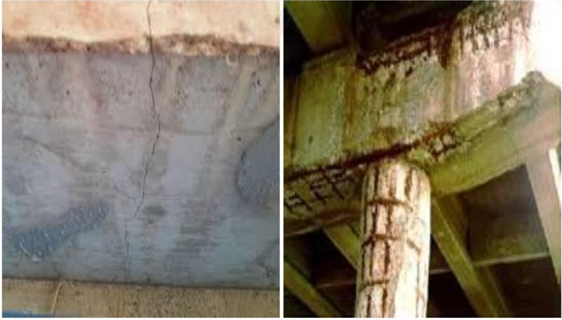
Şekil 2.4: Sülfat etkisine maruz kalmış yapı elemanları
