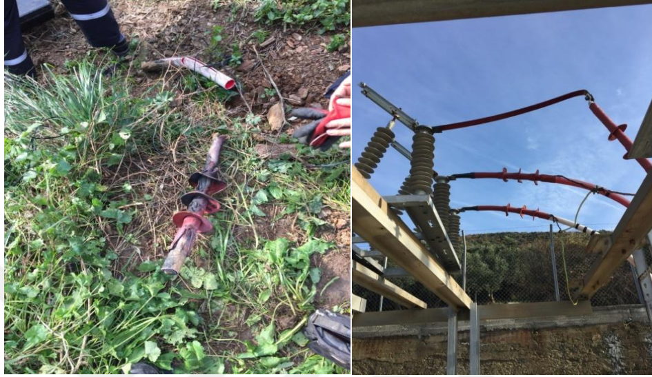
Şekil 3-7: XLPE İzoleli Kablo Başlığı Patlaması ve Yenilenmesi
