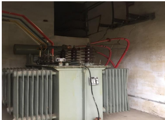
Şekil 3-5: Bina İçerisindeki Transformatör
