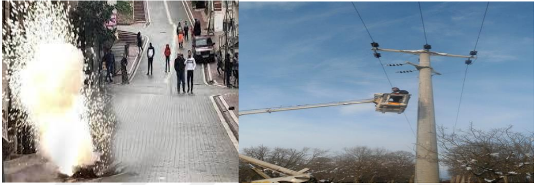
Şekil 3-11: OG yeraltı Kablo Patlaması ve Kopan İletkenin Yenilenmesi
