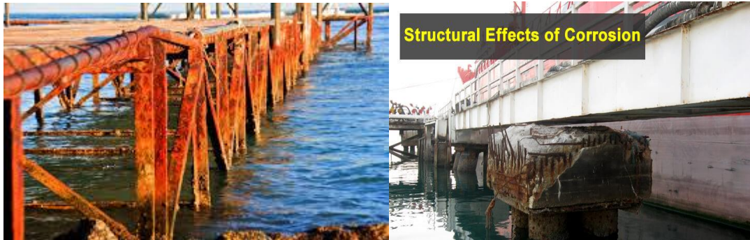
Şekil 2.8. Korozyona uğramış deniz yapıları [25]
