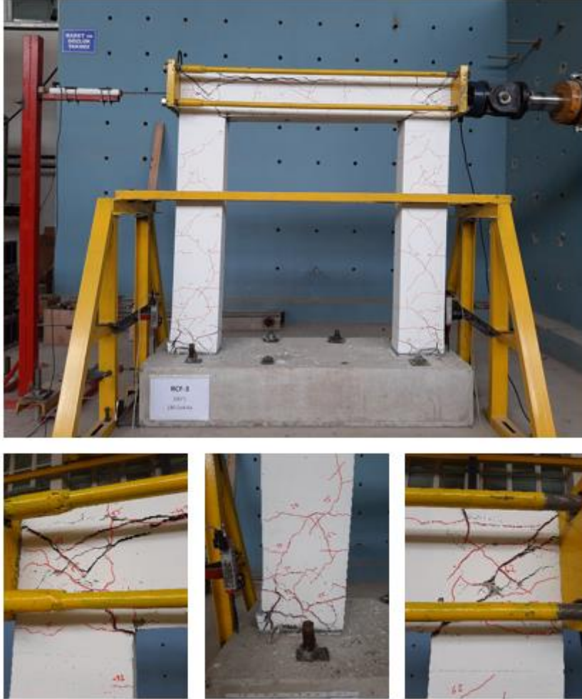
Şekil 74. Deney sonu RCF_3_200_180 deney elemanında oluşan hasar durumları
