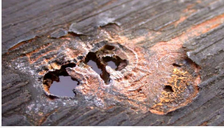
Şekil 1.10. Çukur korozyon türünün görseli.
