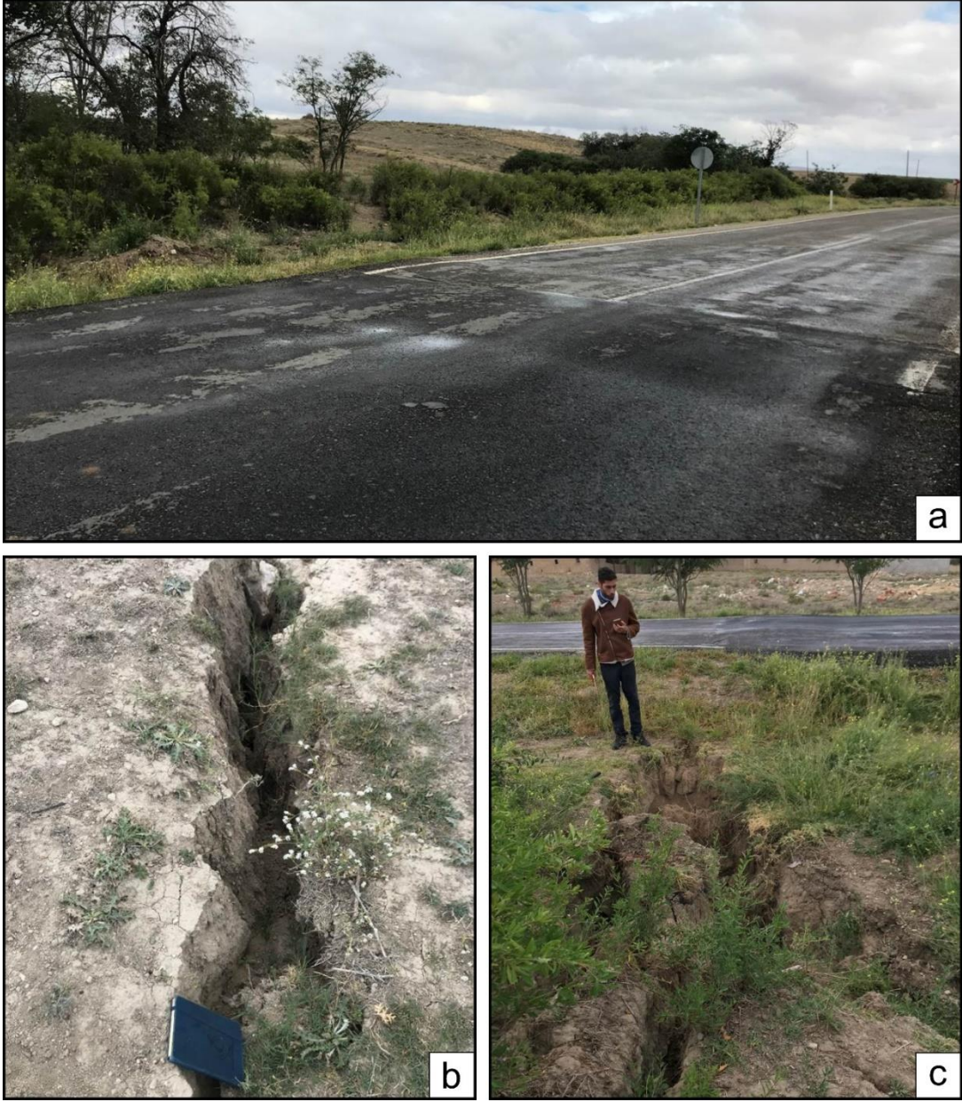
Şekil 3.50 Tuzlukçu doğusunda yer alan Çöğürlü Köyü ve yakın civarında gözlenen asismik yüzey deformasyonlarına ait saha fotoğrafları, a) Asfalt yoldaki düşey yönde yer değiştirme, b) Bölgedeki asismik yüzey deformasyonları, c) Bölgede bulunan asismik yüzey deformasyonun düşey yöndeki yer değişimi.
