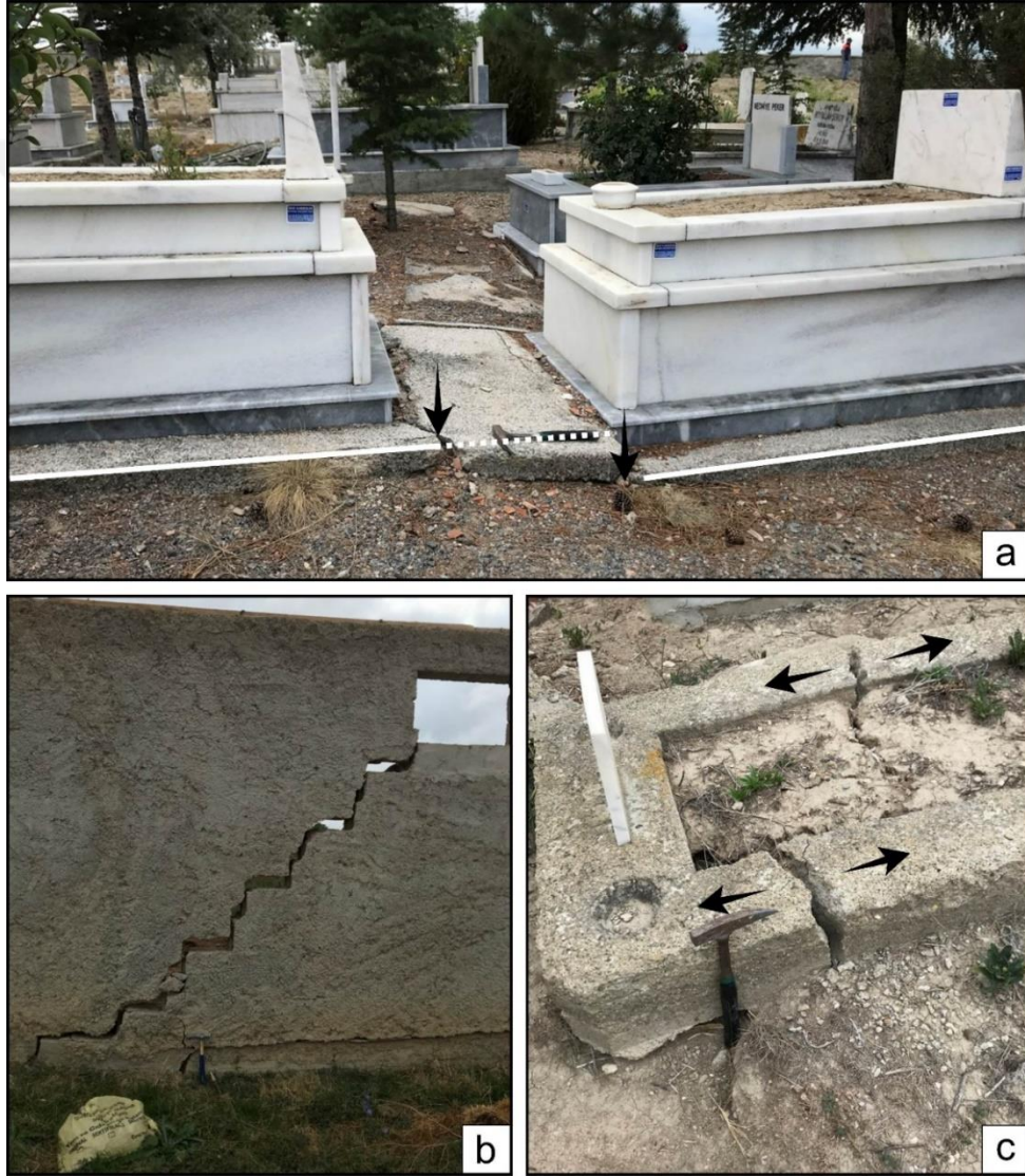
Şekil 3.51 Tuzlukçu bölgesindeki gözlenen asismik yüzey deformasyonlarına ait saha fotoğrafları, a) Düşey yönde yer değiştirme ile deformasyona uğramış mezar, b) Açılmalar ve düşey yönde yer değiştirme ile deformasyona uğramış mezar duvarı, c) Asismik yüzey deformasyonları tarafından deforme olmuş bahçe duvarı.
