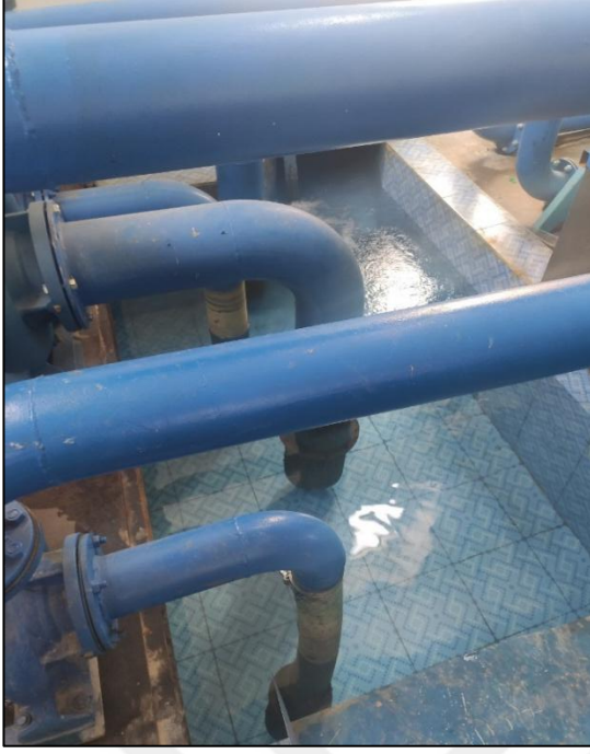
a) Pompa sistemi
