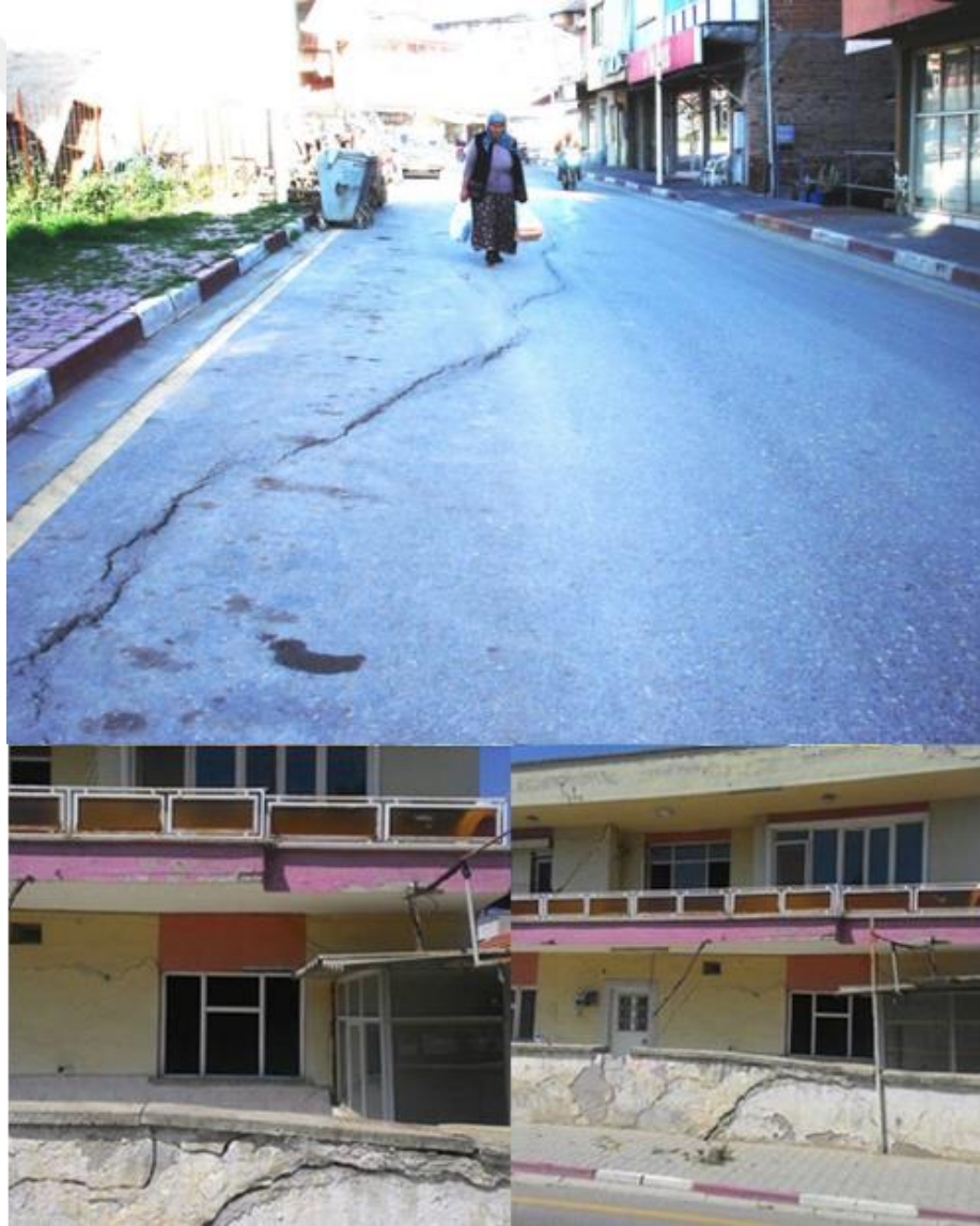
řekil 4.2 Y zey deformasyonları ve hasarlı binalar.
