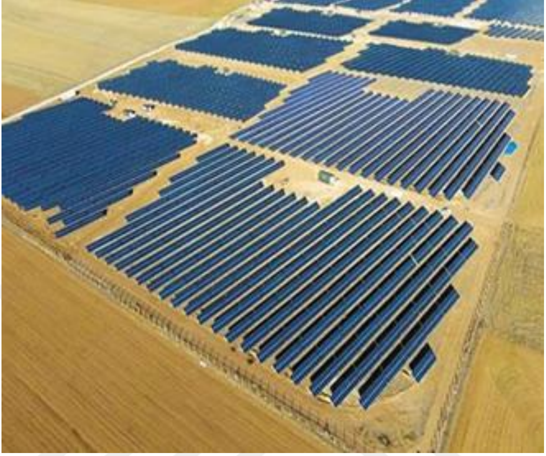
Şekil 2.5. Konya Kızören güneş enerji santrali [21].
