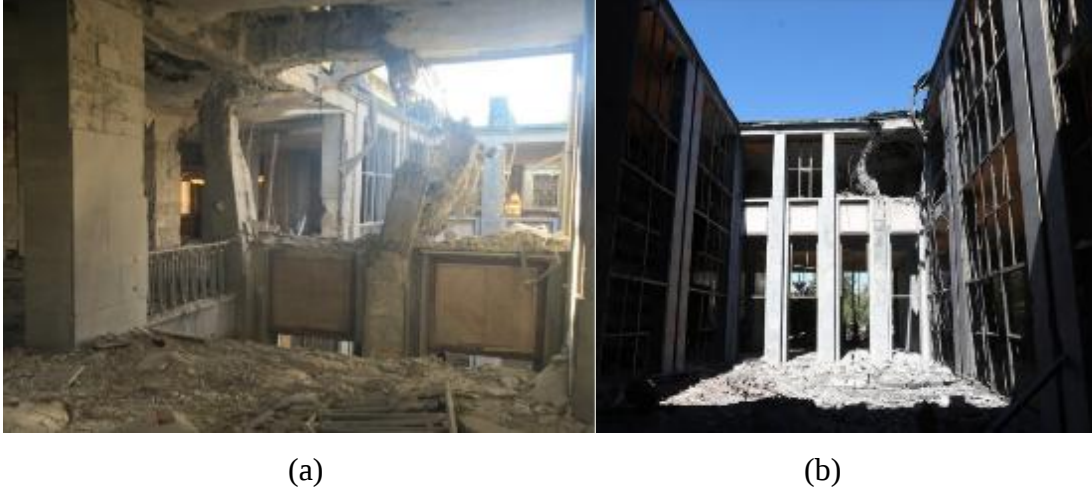
Şekil 7. TBMM, (a) TBMM’de meydana gelen bombalama sonucu oluşan hasar, (b) Binanın karşıdan görünüşü (URL-4, 2018)
