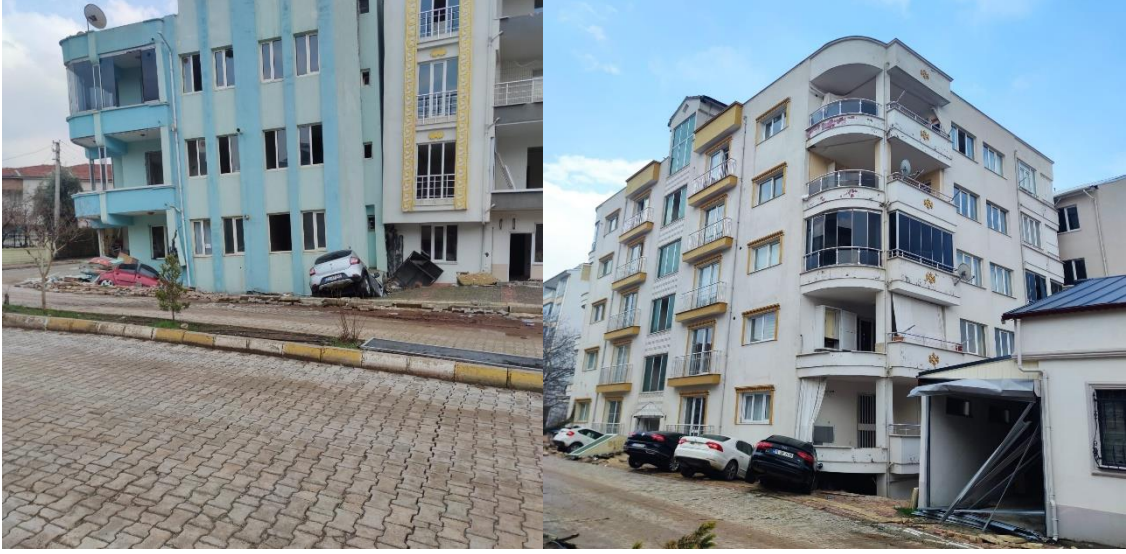
Resim 2. 7. 6 Şubat 2023 Kahramanmaraş-Pazarcık ( M_w = 7.7 ) ve Elbistan ( M_w = 7.6 ) depremleri sonrasında, Adıyaman Gölbaşı ilçesinde sıvılaşma nedeniyle oluşan oturma
