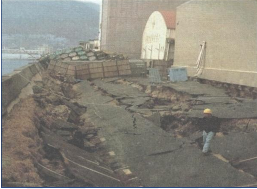
Resim 2. 6. 1995 yılında Kobe depreminde sıvılaşma sonucu oluşan istinat duvarı yenilmesi (Mollamahmutoğlu ve Babuçcu,2006).
