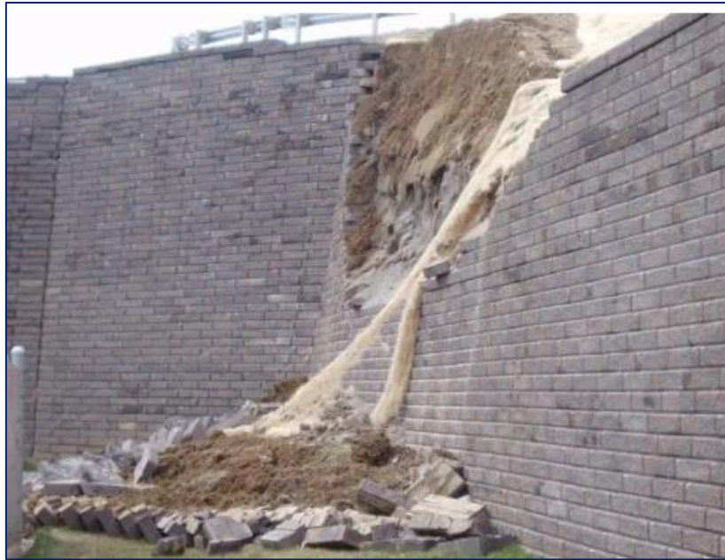
Şekil 3.11. Sıvılaşma sonucu oluşan istinat duvarı yenilmesi ( https://dailycivil.com/soil-liquefaction-causes-effects-and-types/ )
