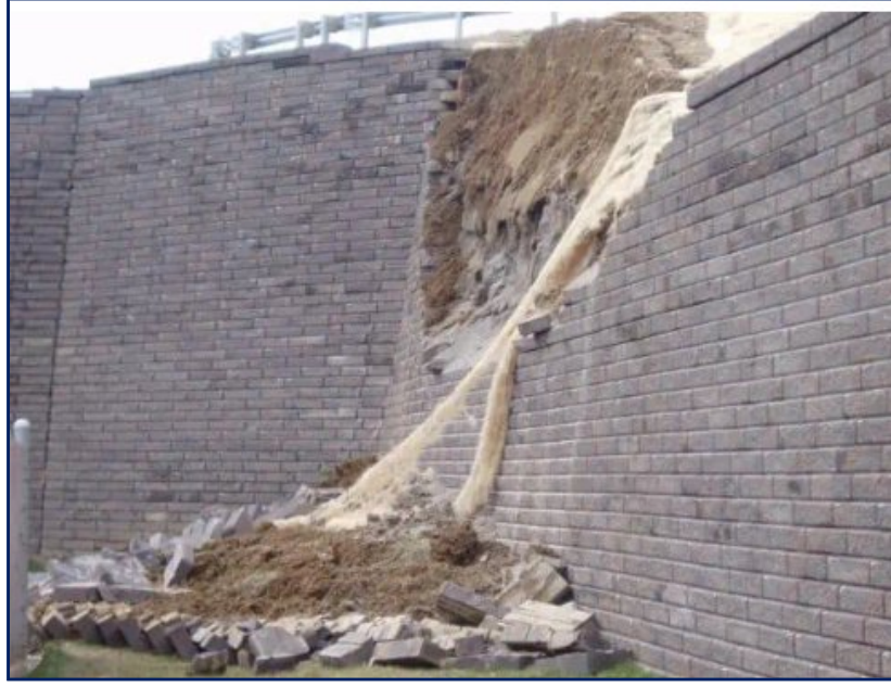
Şekil 3.11. Sıvılaşma sonucu oluşan istinat duvarı yenilmesi ( https://dailycivil.com/soil-liquefaction-causes-effects-and-types/ )
