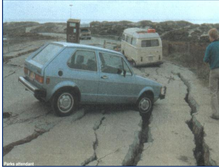
Şekil 3.9. 1989 Loma Prieta depreminde devlet parkı yakınında oluşan yanal yayılma (Mollamahmutoğlu ve Babuçcu,2006)
