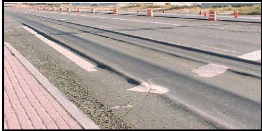
Şekil 2.29. Tekerlek izi oluşumu[19]
