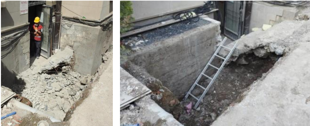
Şekil 5.59. Güney Cephesinde Yemekhaneye Ulaşan Merdivenin Yıkılıp Etrafının Kazılması ve Mevcut Drenaj [75].
